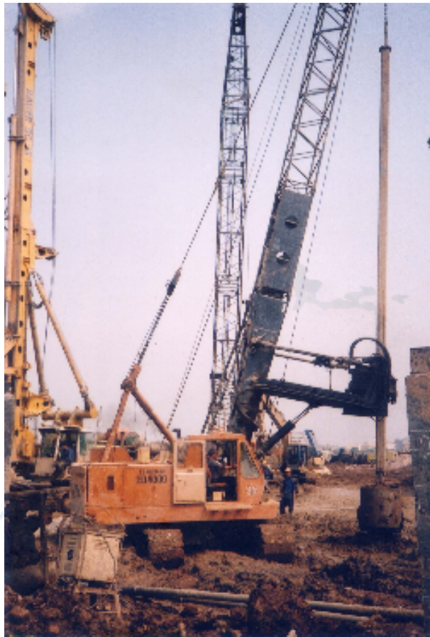
Thi công cọc khoan nhồi bằng máy khoan ED.4000 với bộ gầu khoan xoay đường kính 1,5m.
